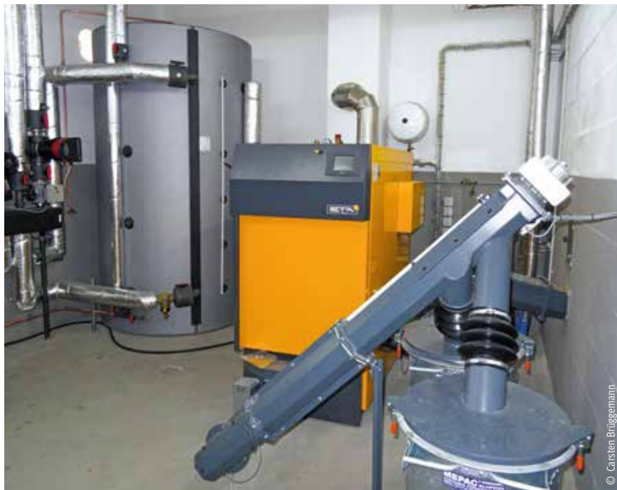
Hackschnitzelheizung mit Pufferspeicher
